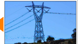
Réseau électrique EDF
